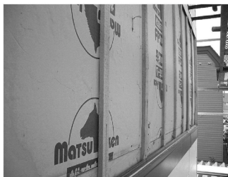
無傷だったFPウレタン断熱パネル
